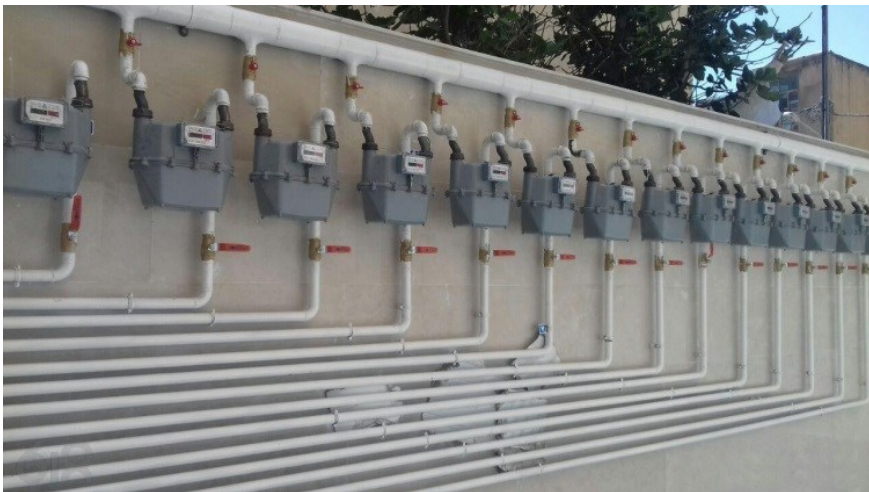
شکل ۲-۱۱- نمایش کنتورهای یک پروژه مسکونی
