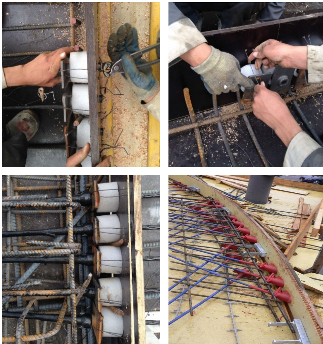
چ نحوه اجرای سر زنده تاندون‌ها در لبه قالب دال و آرماتوربندی اطراف آن در سیستم نجسبیده (انتهای کششی به قالب جداره متصل شده و تاندون‌ها از گیره‌ها عبور داده می‌شوند)
