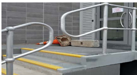
پاگرد پله از ساختمان کنسول شده و بر روی ستونک می لغزد. دستگیره‌ها برای اینکه مانع حرکت نشوند، از هم جدا شده‌اند
