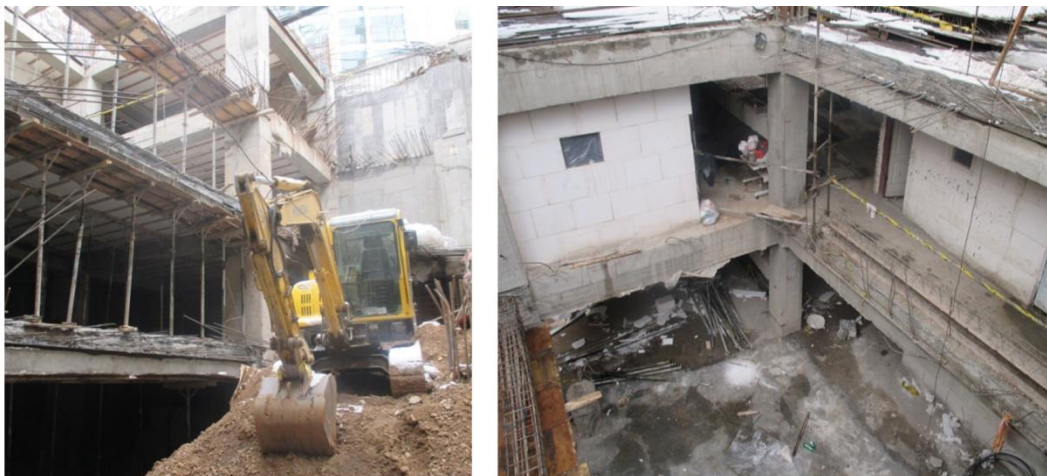
شکل ۱-۱۷ پروژه دیباجی جنوبی - الگوی بومی- اسکلت بتنی با ستونهای درجاریز- عمق گودبرداری ۱۴ متر
