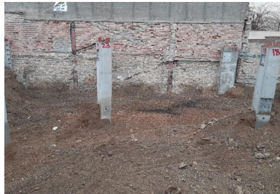
شکل ۳-۹۲ نصب ستون‌های پیش‌ساخته بتنی در سایت پس از پر کردن چاه و آماده‌سازی سایت جهت اجرای سقف و دیوار حائل اولین زیرزمین.
