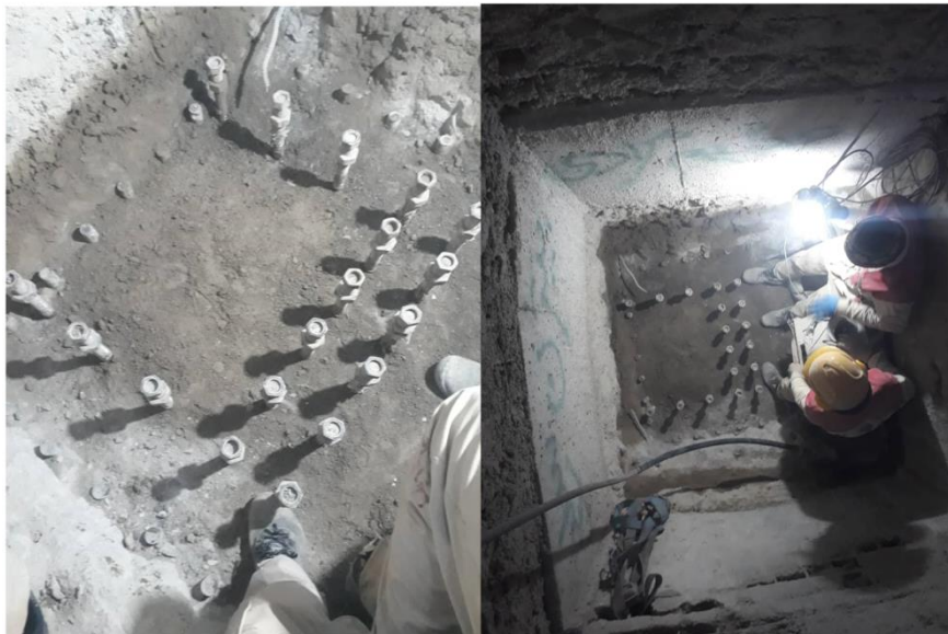
شکل ۳-۲۵ مهارهای اجرا شده در شمع پس از بتن ریزی شمع و خارج کردن شابلون صفحه ستون
