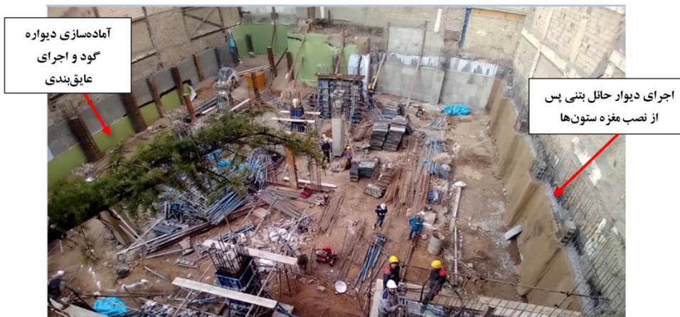
شکل ۳-۹۳ آماده‌سازی جهت اجرای بخش‌های مختلف عملیات ساخت و تعریف جبهه‌های کاری مختلف در پروژه (اسکلت بتنی و ستون‌های با مغزه فولادی در طبقات زیرزمین).
