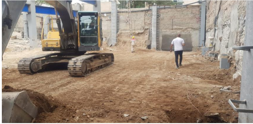
شکل ۳-۹۱ نصب ستون‌های فولادی، پر کردن چاه و سپس تسطیح کف گود به منظور ادامه عملیات اجرایی ساخت به روش بالا-پایین.
