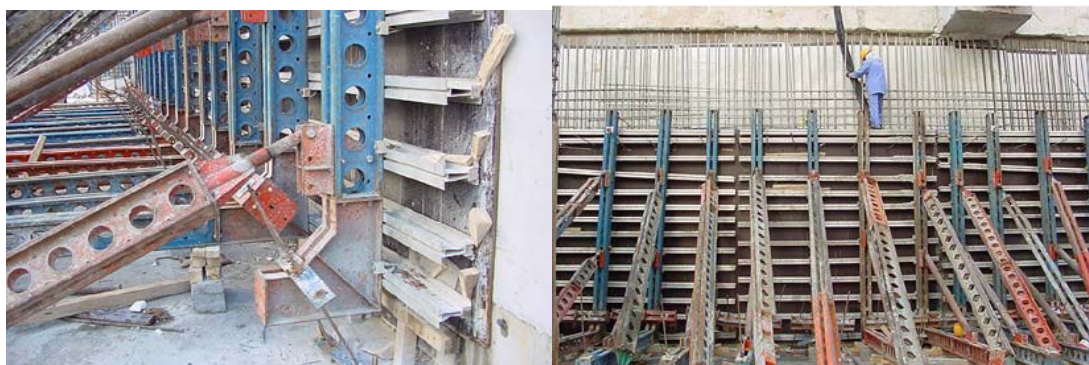
شکل ۱-۷ لزوم دقت در قالب‌بندی و درزبندی و همچنین افزایش پشت‌بند و مهارهای لازم، در بتن‌ریزی با SCC
